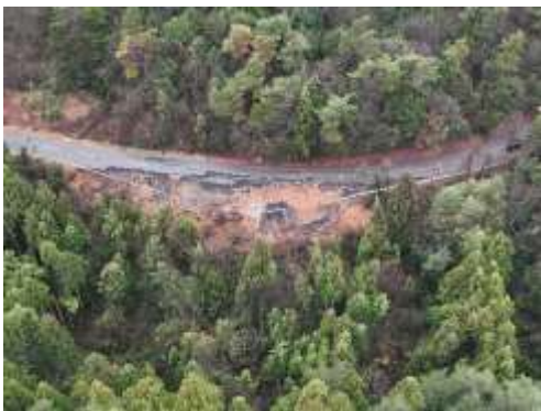
空撮写真(被災状況)
