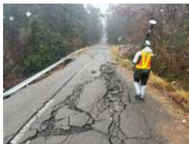
道路崩落の被災状況調査
