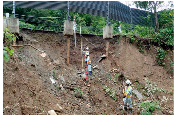
(県道の法面崩壊箇所の調査)
